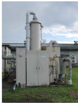
地下水浄化装置（青森事業所）
