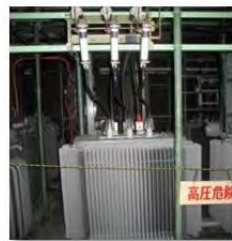
本社に導入された高効率変圧器
