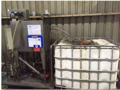
FGA (THAILAND) の油水分離装置
