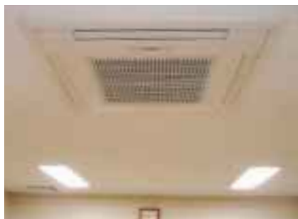
省エネタイプに更新された事務所の空調設備
