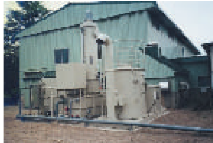
地下水浄化設備((株)青森富士通ゼネラル)
