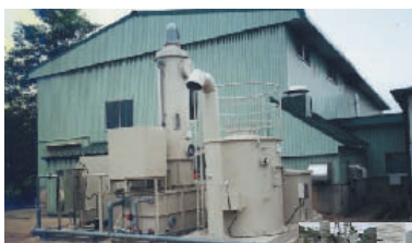
地下水浄化設備 ((株)青森富士通ゼネラル)
