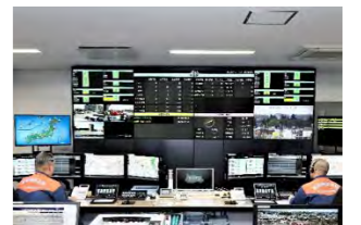
消防・救急通信指令システム
