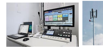
防災システム
