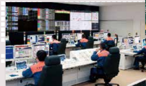
消防システム
