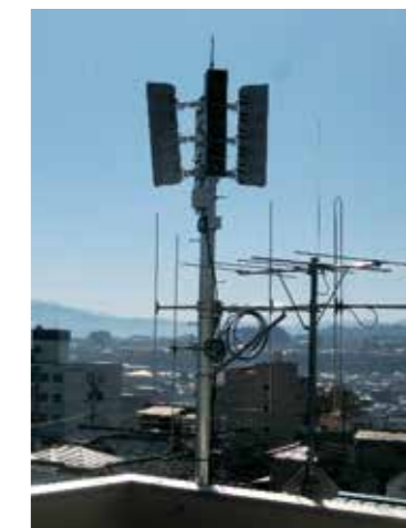
飯田市役所屋上設置の屋外子
