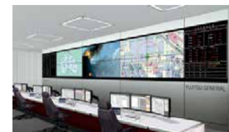
消防システム
