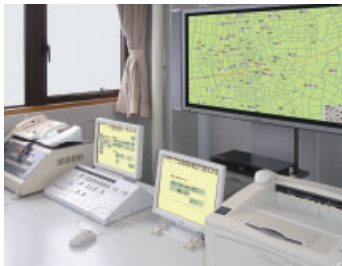
防災無線システム（茨城県筑西市様）
